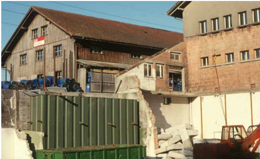
Im Mai 2000 wurde bei der heutigen Landi die einstige Schnapsbrennerei abgebrochen, wenig später das hölzerne Lagerhaus für Futtermittel. Der grüne Öltank diente im einstigen Kohlenbunker der 1974 eingeführten Ölfeuerung für die Dampferzeugung der Brennöfen. (Foto: Urs Berger)
