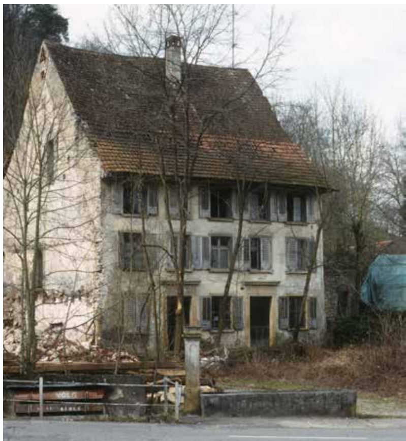
Im März 2002 präsentierte sich das imposante Wohnhaus mit Mühle in einem desolaten Zustand. Kurz danach erfolgte der Abbruch. Der mehr als doppelt so lange Ökonomieteil musste aus Sicherheitsgründen schon zwei Jahre zuvor abgebrochen werden. (Foto: Urs Berger)
